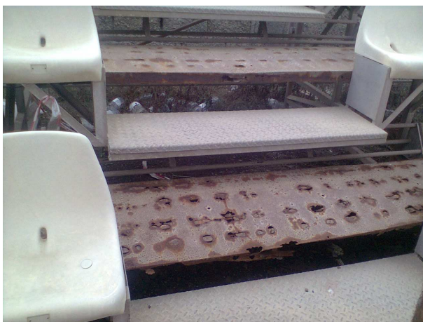
Fig. 13: Pedane e scale da sostituire
