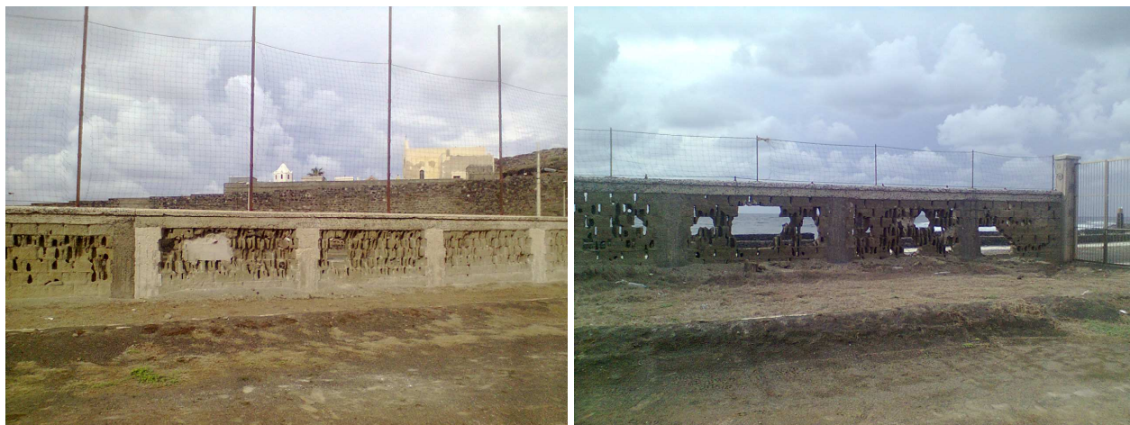
Fig. 3 e 4: Lo stato attuale della muratura a recinzione del plesso sportivo
