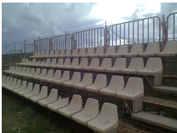
Fig. 12: Area tribuna (sedili danneggiati)
